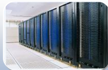
データセンター
