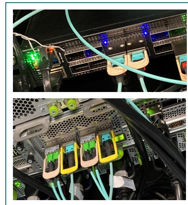
AOC接続検証時の写真
