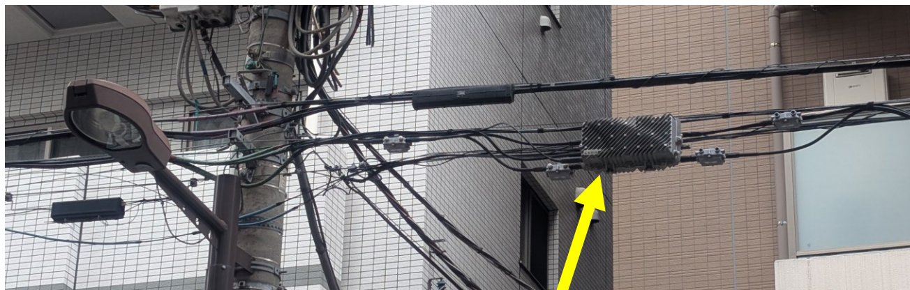
CATVの場合はHFCノードや アンプが目印
