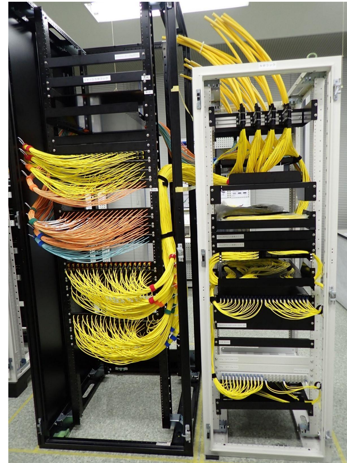
GPUインターコネクト ネットワークラック
