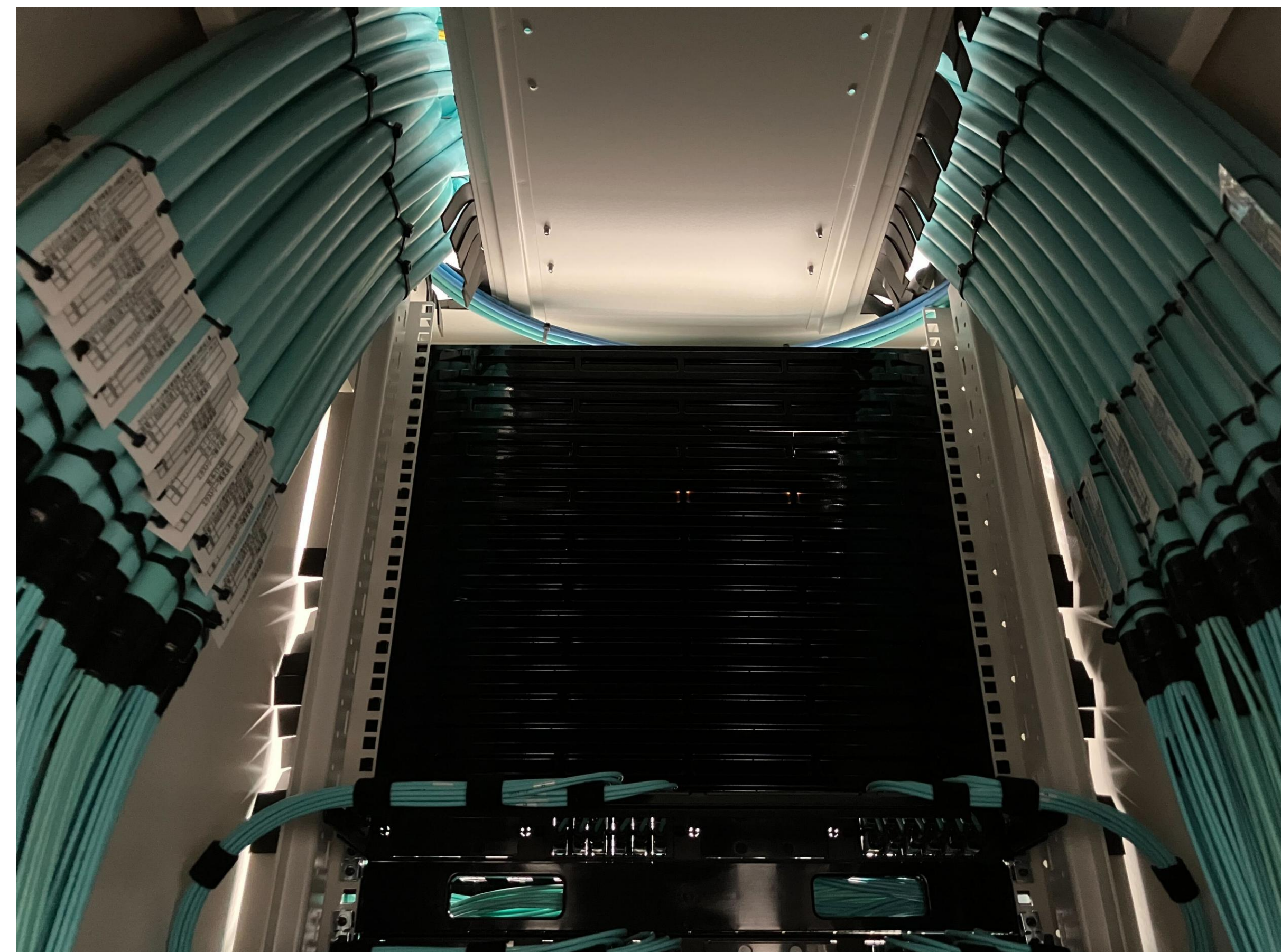
パッチパネル内部(背面から)
