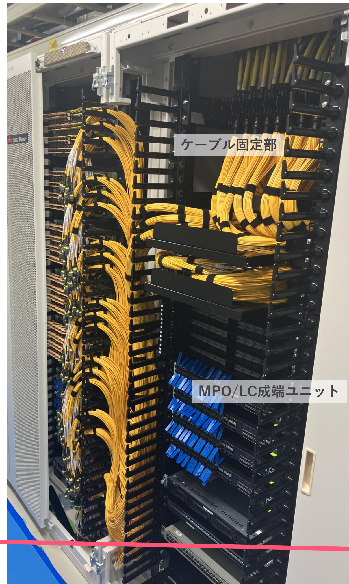
ケーブル引き込みラック
